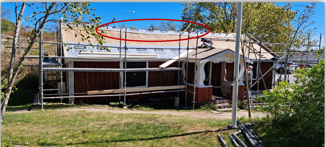
Det visar sig att taket "sviktar" ca 160 mm på mitten vilket gör att arbetet försenas ca 1 vecka med tillhörande kostnader som Kattkullens Bygg AB tar utan diskussion.....
